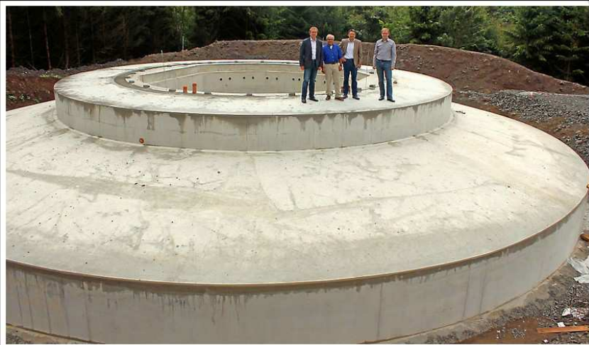
600 Kubikmeter Beton hat das Fundament für die Windkraftanlage verschlungen. Mehr als 70 Tonnen Stahl sind darin verschwunden. Von dem Fundament wird nach dem Befüllen nur noch der kleinere, obere Ring zu sehen sein. In die Öffnung wird der Hybridturm verankert. Thomas Scholz, Herbert Schuld, Michael Koch und Jouke Landman machten sich vor Ort ein Bild vom Stand der Arbeiten. (Foto: Henche)
