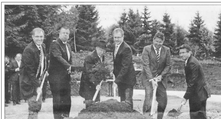
Mit dem Spatenstoß können die Arbeiten auf dem Knoten in Mengerskirchen beginnen (v. l.): Jouke Landmann (Süwag), Regierungspräsident Lars Witteck, Hermann Hofmann (Hermann Hofmann Gruppe), Bürgermeister Thomas Scholz, Dirk Pumplun (Süwag) und Michael Koch (Hermann Hofmann Gruppe). (Foto: Strabheim)
